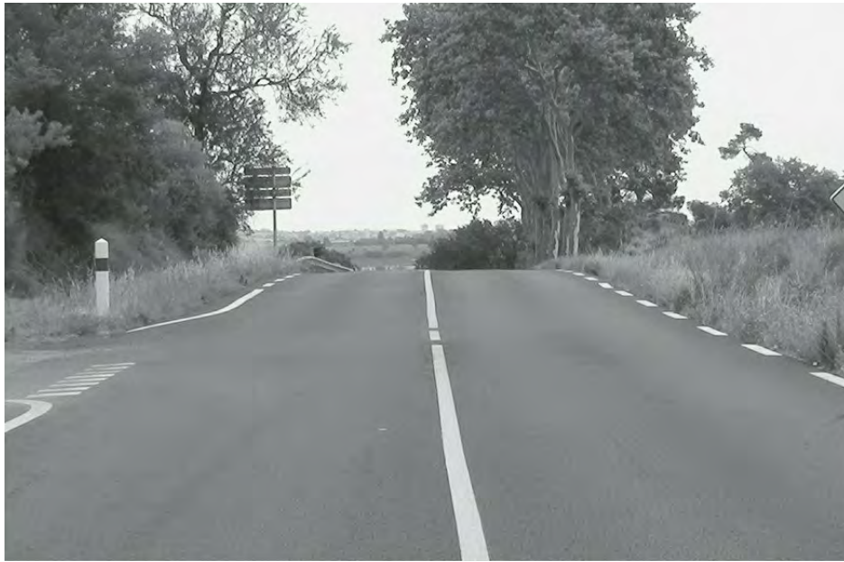
Figure 6.1 Sur cette route principale, la valeur du rayon en angle saillant ne permet pas d'assurer la visibilité sur l'intersection.
