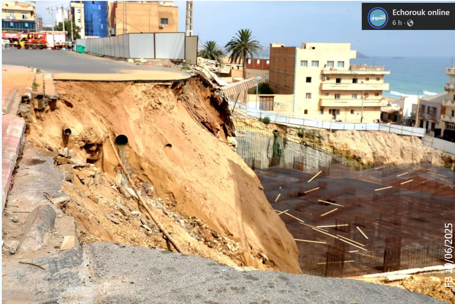
Glissement de terrain d'Ain Turck, Oran (10/06/2025)
