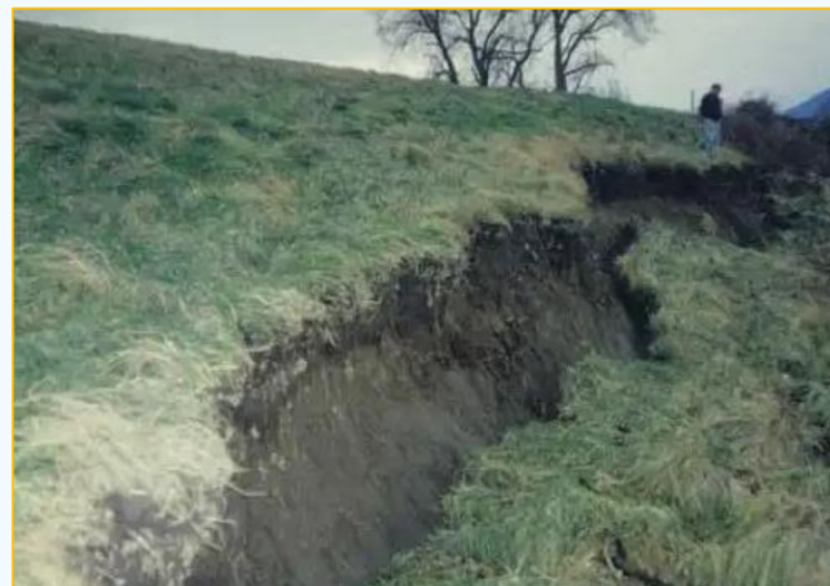
Glissement de terrain
