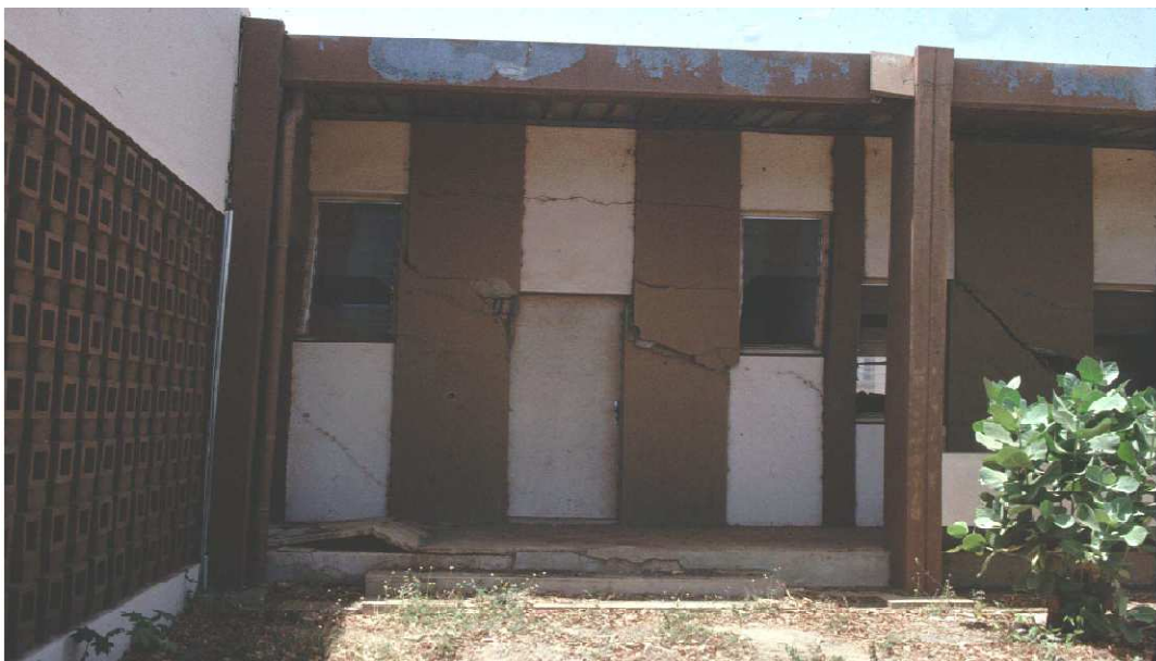
Figure : Vue des désordres provoqués par des marnes gonflantes
