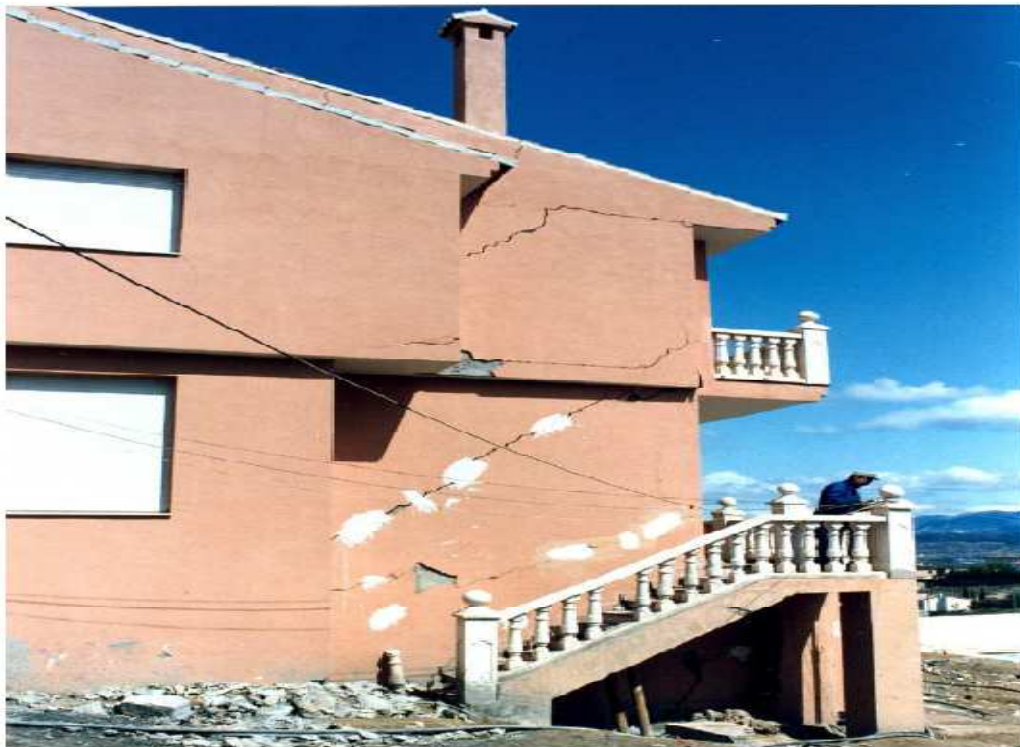
Figure : Vue des dommages sur une maison individuelle située en crête de talus,
