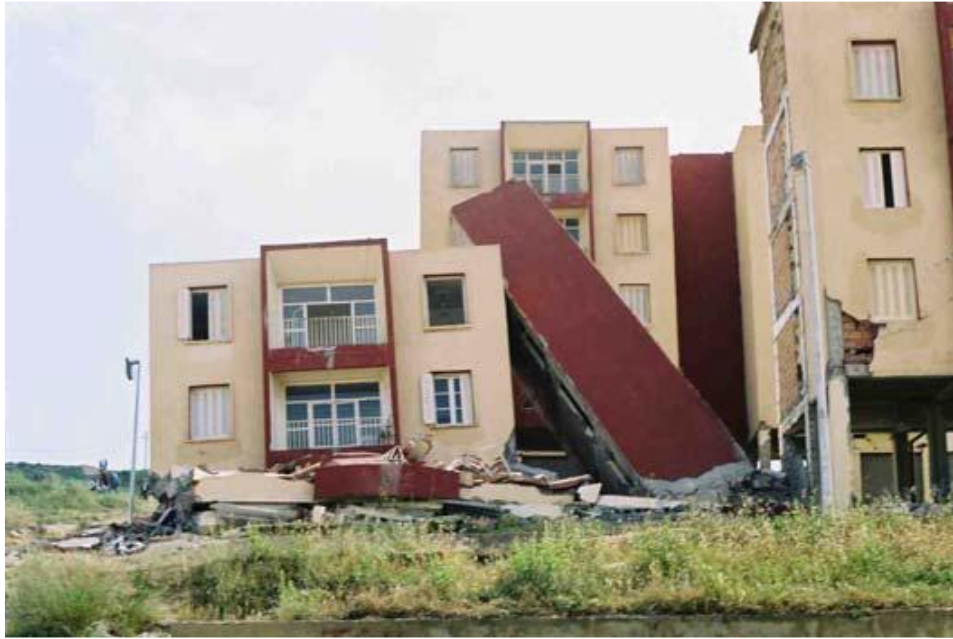
Basculement d'un bâtiment par cisaillement de sa base
