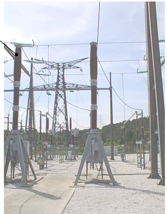
---- disjoncteur 63 kV au SF6 ----
