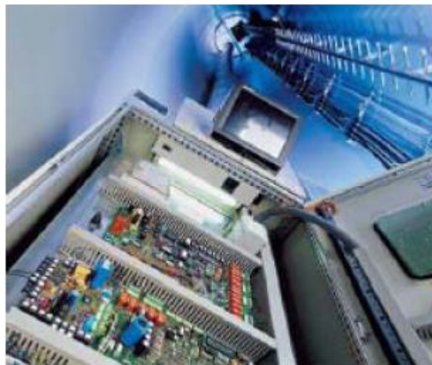
Contrôleur Enercon en pied de mât
